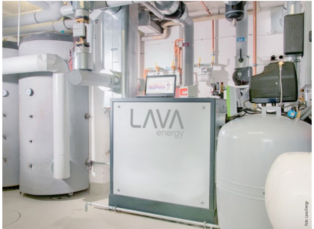
Die Heiztechnik wird von Lava überwacht
